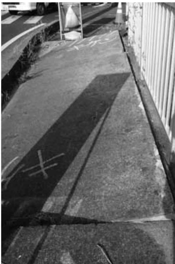
茨城県潮来市の県道上にて。震災によって路肩が傾き危険なため、通行不可となっている。北関東にはまだ修復されていないインフラも多く、明らかに被災地だといえよう。
